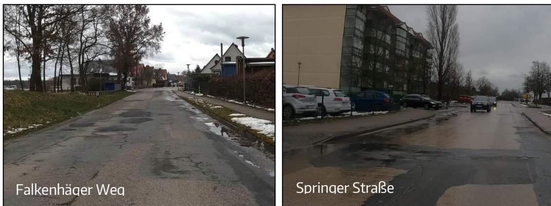
Abb. 7 Oberflächendefizite im Ergänzungsstraßennetz
