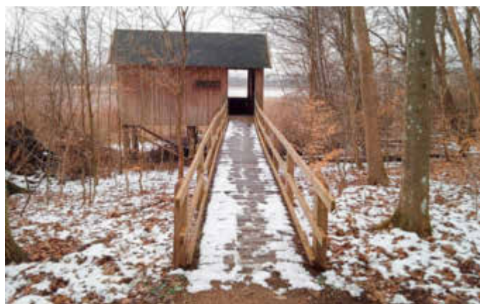
Der Bohlenweg des Beobachtungspunktes am Federower Hofsee wird derzeit erneuert. Foto: R. Gipp
